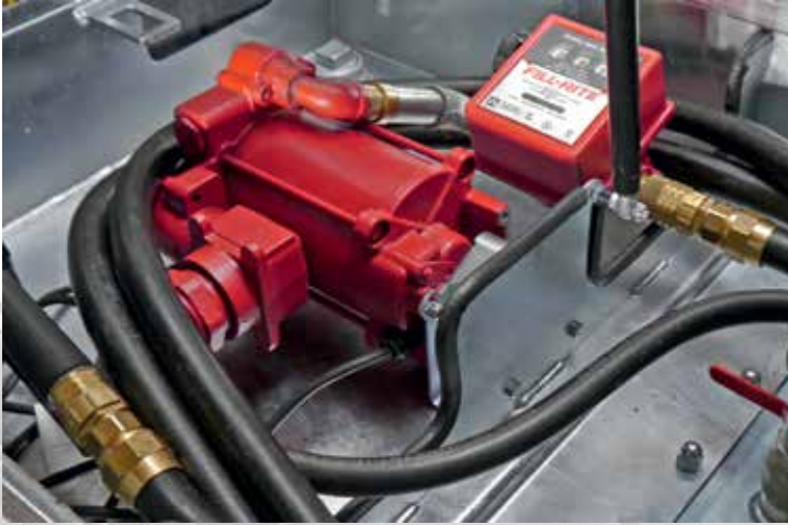
Pumpenset für Benzin und Diesel
